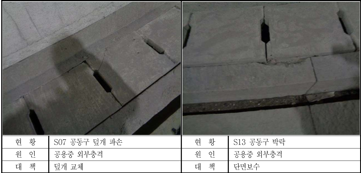
【사진 2.3.9】 공동구 및 배수시설 손상현황
